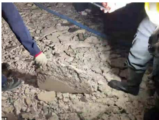
剥離したコンクリートが路面に散乱
