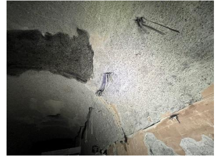
トンネル側面の剥離
