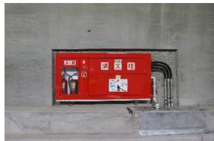
トンネル設備 (消火栓)
