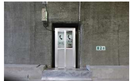
トンネル設備 (非常用電話)
