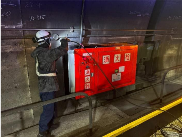
《トンネル非常用設備点検》
