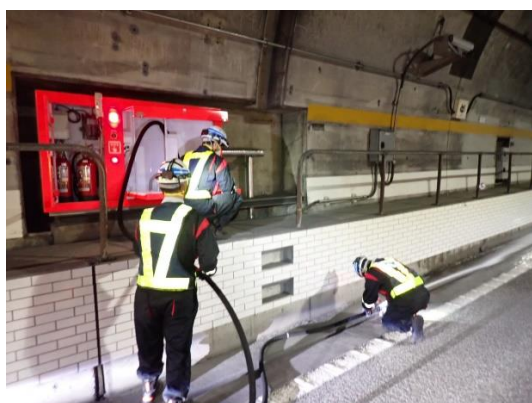
< トンネル非常用設備点検 >
