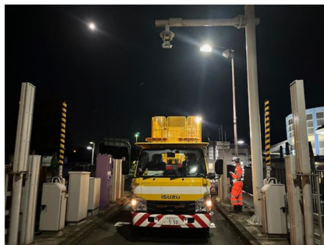
照明設備点検
