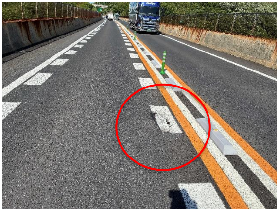
《補修箇所② 施工前》
