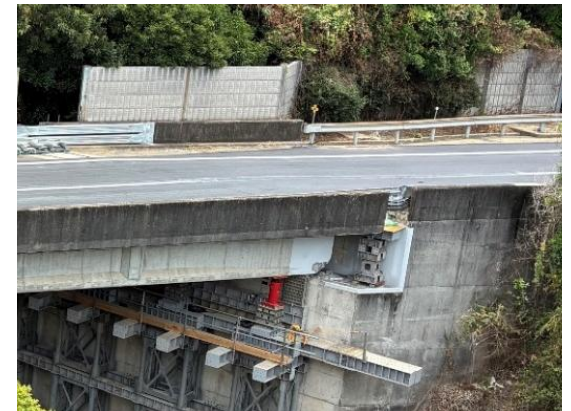
応急復旧(一般車両通行可能)
