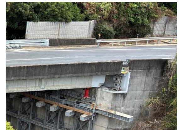
応急復旧(一般車両通行可能)
