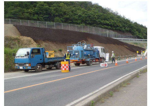
【参考】種吹付設備
