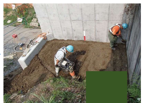
構造物裏込め
