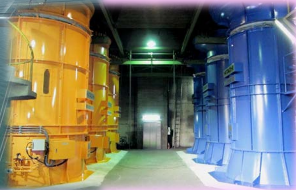
平成28年度に新しくなった 関門トンネル換気設備です!
